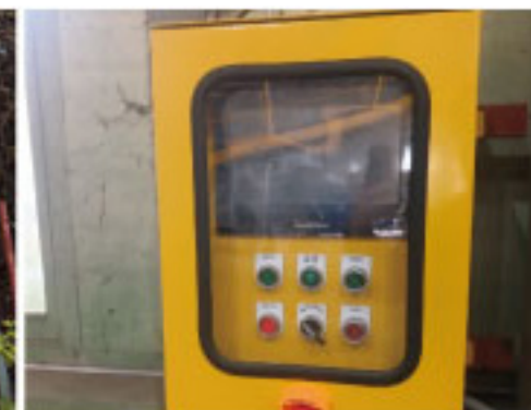
터치(조작)판넬 설비 사진
