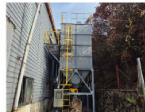
집진기 및 전기판넬 설비 사진
